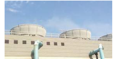
冷卻水塔裝置除霧節水系統 (左) 後白色霧氣減少
