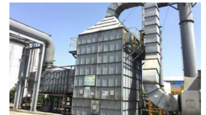
遠紡織染（蘇州）設置定型機煙氣淨化裝置
