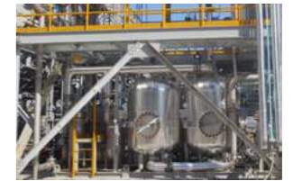
壓力過濾機設備
