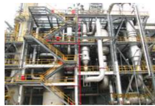
製程餘熱回收再利用設備
